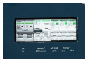
Protection AC et DC
